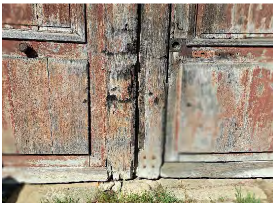
Détail de l'état préoccupant de la porte
