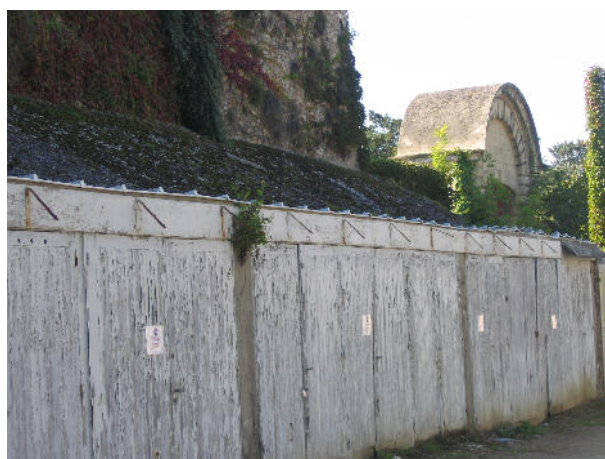
Fig. 7 - Les garages amiantés, vestiges d'une époque révolue.
